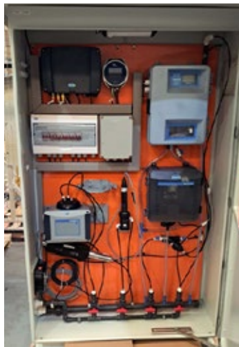
Skid para medição de pH, Cloro, Flúor, Turbidez e Cor
