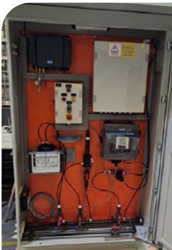
Skid para medição de pH, Cloro e Turbidez
