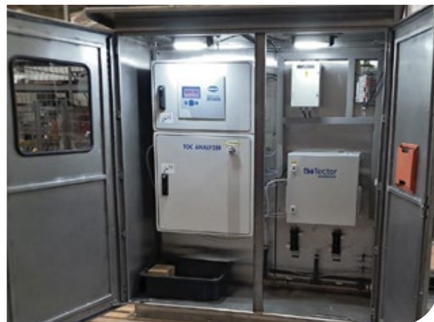
Gabinete em Inox, refrigerado, para medição de TOC
